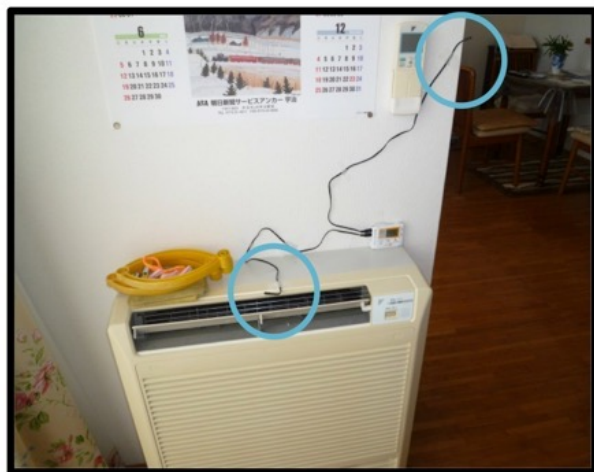
エアコンの吹き出し口
