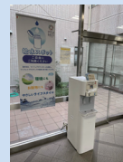
公共施設に給水機を設置(豊中市※4)
